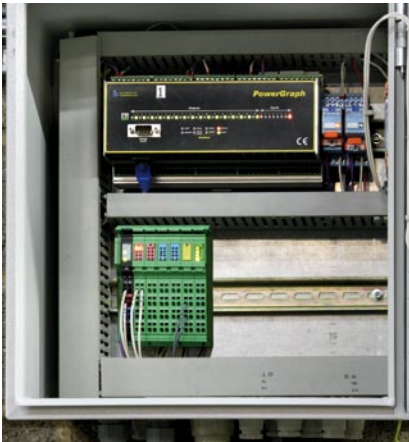
Draadloze multiplexer geïnstalleerd bij de Powergraph energie-registratieinstallatie: dag en nacht
