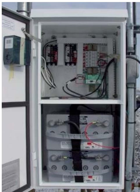
De eiland-solarinstallatie bestaat uit een zonnepaneel, oplaadregeling en accu. Het RAD-ISM-900-DATA-BD-BUS-moduul registreert het analoge niveau- en het digitale alarmsignaal en draagt dit over aan de centrale.
